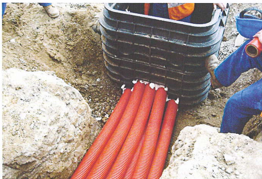
Kabelové komory - ilustrační foto
